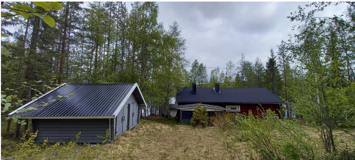
Kuva 12. Suunnittelualueen kaavamuutosalueella rantavyöhykkeellä sijaitseva vapaa-ajan asunto on kunnoltaan välttävä eikä sovellu enää sellaisenaan vapaa-ajan käyttöön. © J. Lokio 8/2023
